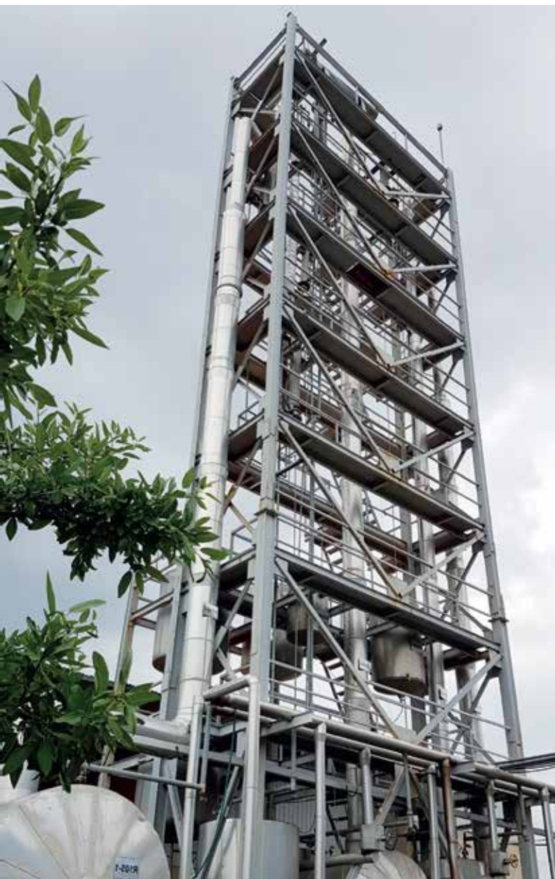
“مجموعه برج های تقطير مرتفع مستقر در كارخانه اراك”
